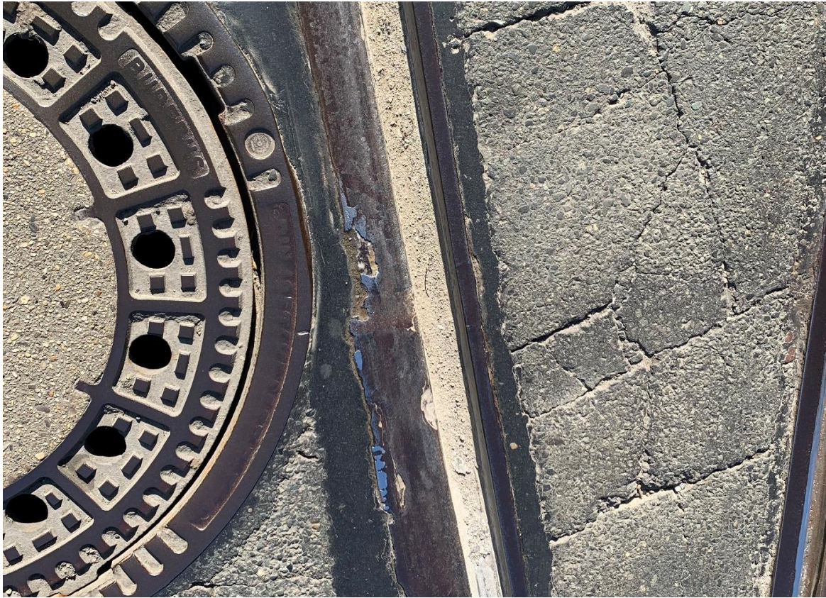
Abbildung 9: Verschleiß am Gleisdreieck Pirckheimerstraße
