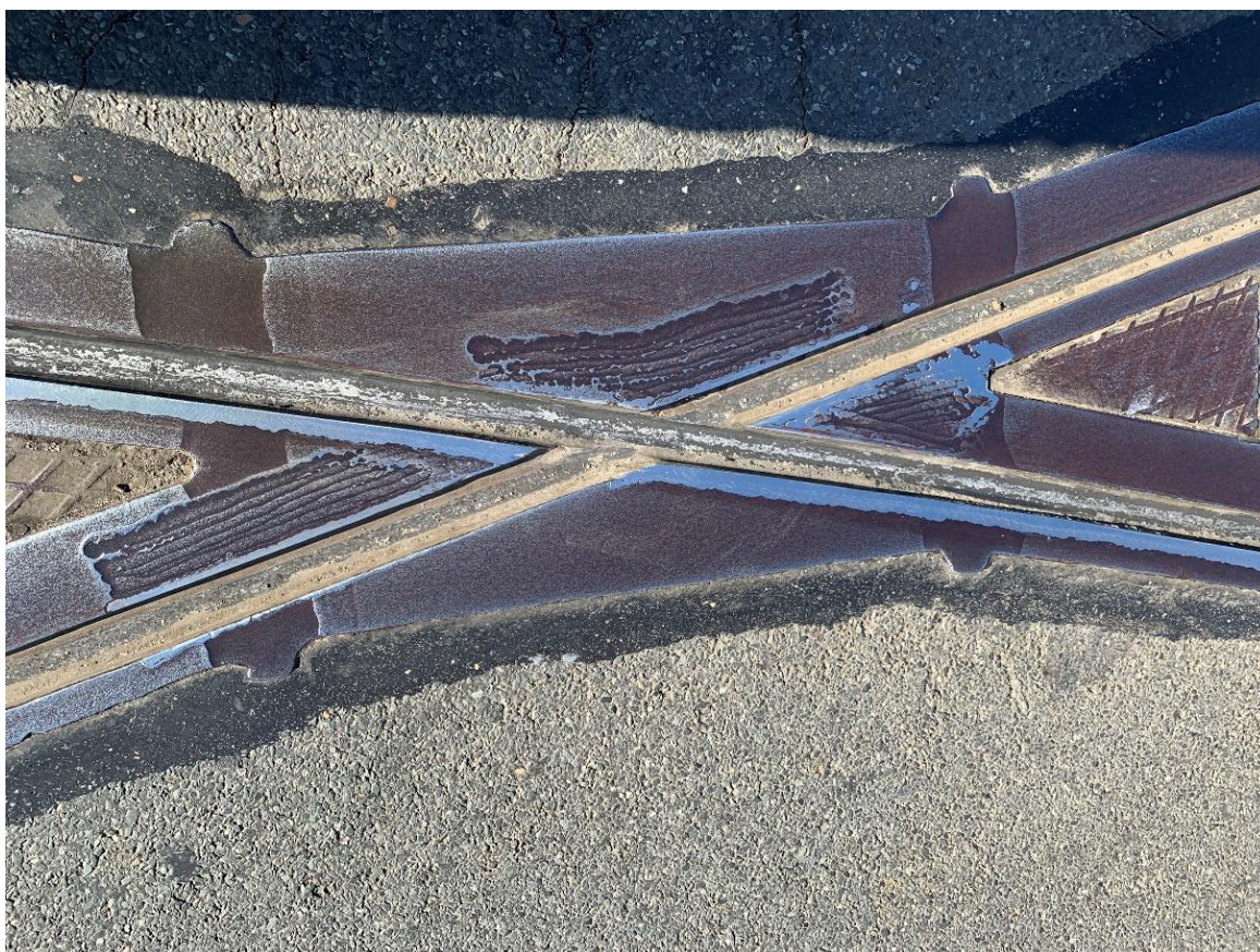
Abbildung 4: Verschleiß an Gleiskreuzung Rathenauplatz
