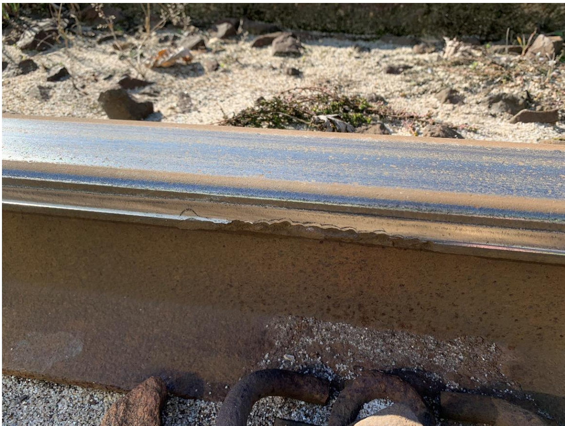
Abbildung 6: Verschleiß an Schiene zwischen Rathenauplatz und Rennweg
