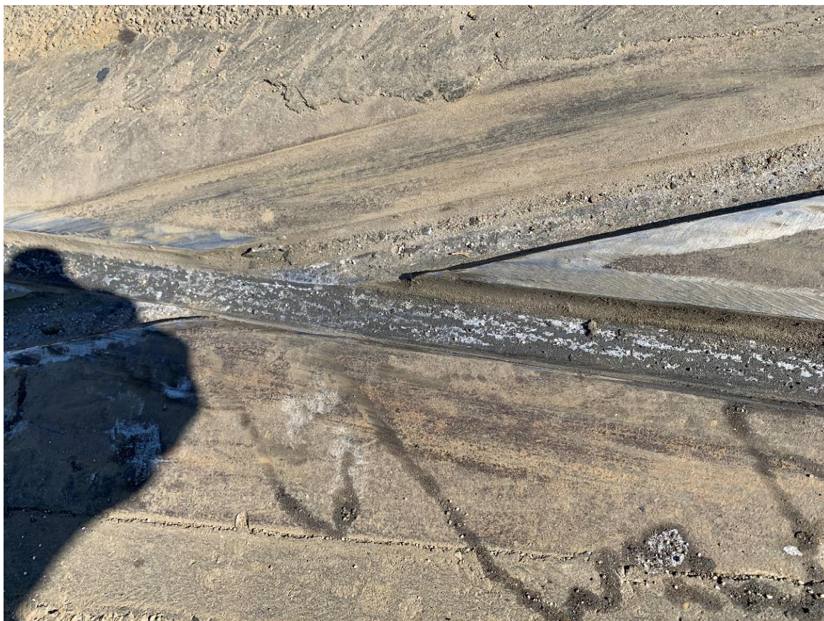
Abbildung 3: Verschleiß an Gleiskreuzung Rathenauplatz
